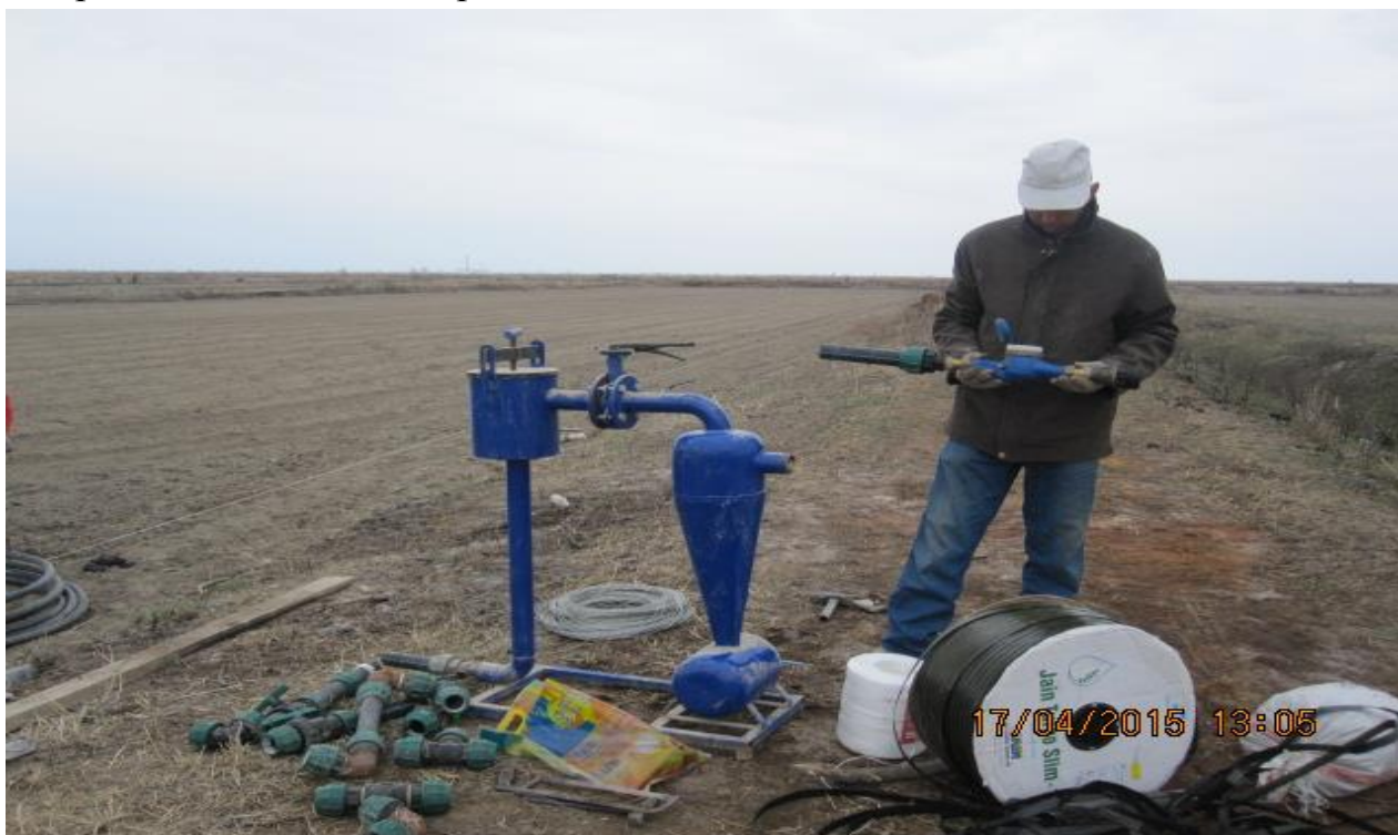
Рис. 1. Фильтрованная станция с дозатором
