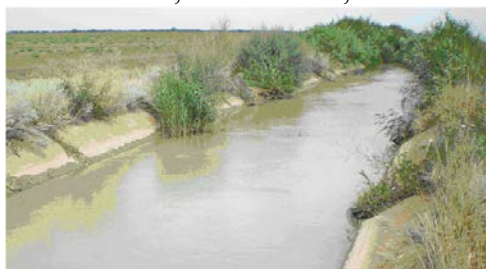
Зарастание сорной растительностью бетонного русла канала (Дивенский распределитель в Ставропольском крае)
